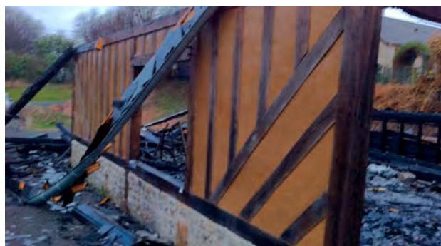
Incendie intérieur ayant détruit une construction. Le mur en béton de chanvre a résisté.
